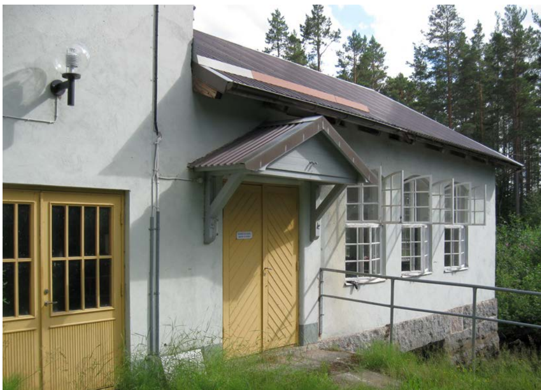
Del av Dala-Järna kraftstation (foto: Anders M, Lst Dalarna 2010).
